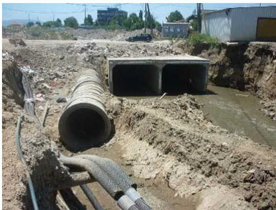
Figura 6-2: Derdhjet kryesore përfundimtare e ujërave të zeza në Prishtinë
